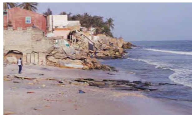
Photo 34 : Dégâts à Bargny en 2014 (2)
