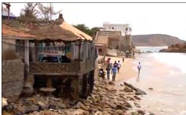
Photo 40 : Avancée très marquée de la mer à Joal-Fadhiout (disparition de maisons et d'hôtels)
