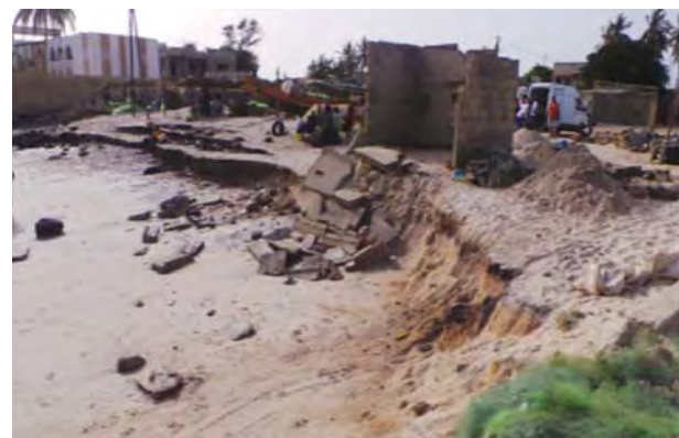
Photo 33 : Dégâts à Bargny en 2014 (1)
