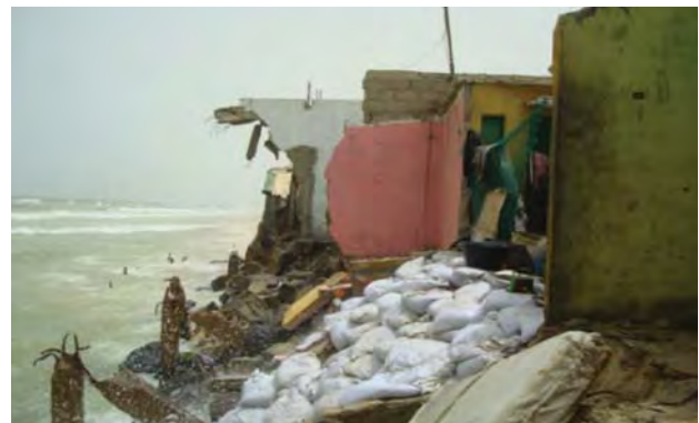
Photo 23 : Dégâts occasionnés par les houles et les vents à Nguet Ndar (Source, DEEC, 2014).
